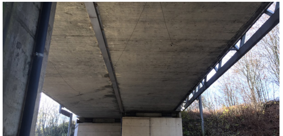
Installation Sensorik an einem Messobjekt
